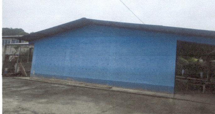
Foto 6: el salón que sera sustituido de techo
